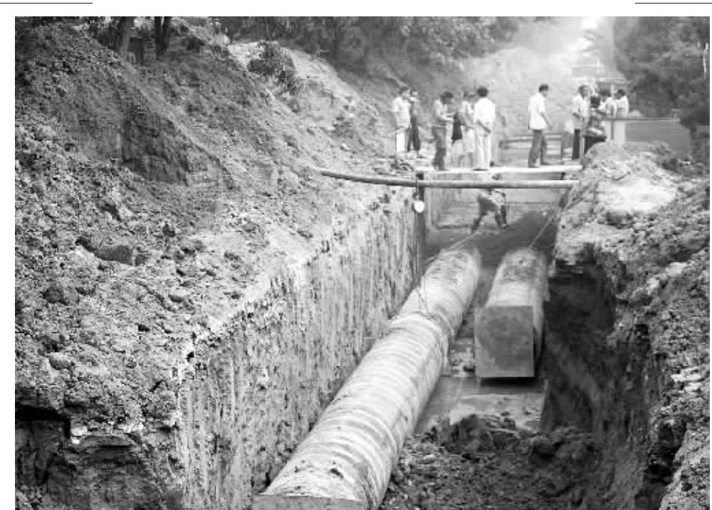
昨日,热力公司的工人正在紧张施工。晚报首席记者 魏文慧 摄
