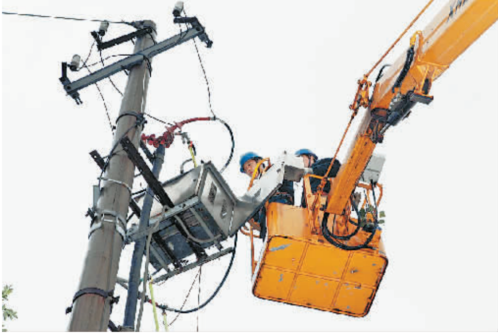
连日来的雷雨天气,造成多条线路受损。为尽快恢复供电,电力部门积极抢修,目前市内和郊区所有故障线路已恢复正常运行。市民若遇电力故障,可拨打95598联系维修。晚报首席记者 魏文慧 摄
