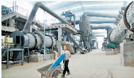
丰四方化肥:这是丰四方化肥科技有限公司新落成的复合肥生产线。该项目由河南天帮肥业有限公司投资兴建,总投资3亿元,引进年产10万吨复合肥生产线4条,主要装备有转鼓造粒机、回转烘干机、回转冷却机、粉碎机及配套辅助设备,项目建成后可年产优质复合肥40万吨。
