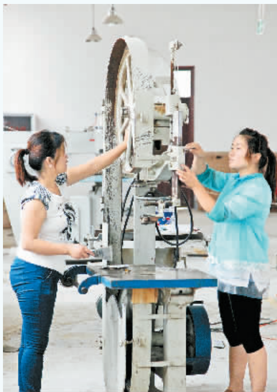
家美特家具：家美特家具有限公司的员工在安装生产线设备。这家即将投产的公司由浙江省佳美特家具有限公司投资兴建，总投资 1.8 亿元，建设年产 2.5 万套系列家具生产线。商丘日报记者 傅青 摄
