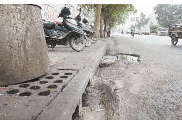
饭店的油烟通过这个下水管道排到了路上。
