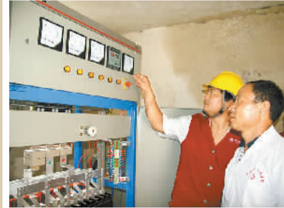
宁陵供电局红马甲服务队定期对医院供电设备进行检修,确保其安全稳定用电。
