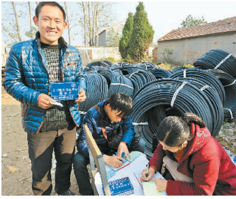
11月9日,宁陵县赵村乡农民王杰在领到农村安全饮水门牌时高兴得合不拢嘴。去年以来,该县水务局在全县11个乡镇和47所学校实施农村饮水安全工程,累计投入水利建设资金4000万元,使15万群众吃上了安全、清洁的自来水。吕志莉摄
