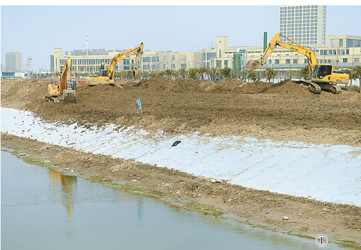
①4月7日,大型挖掘机在商均路旁沙河清淤现场作业。东沙河示范区段总长度18公里,域内流域面积1349亩,通过治理,将实现河道全面清淤,排污口全面封堵,全域实行截污纳管。同时,东沙河与商均路交会处将建成示范区沙河公园,河道两岸各建成60米宽绿色生态走廊,同时修建自行车道。
