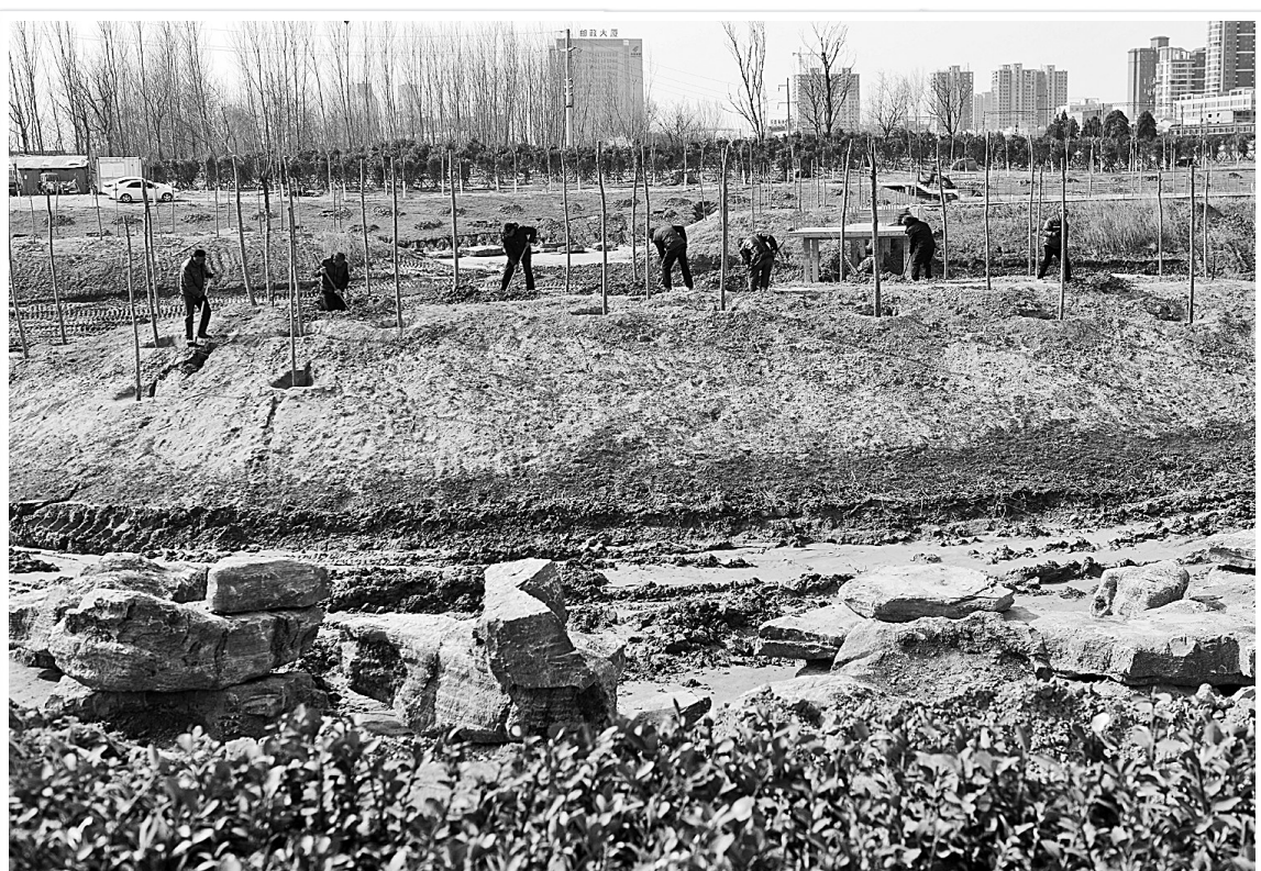
4月10日，园林工人在运河公园栽种景观树木。示范区运河公园绿化工程东起长江东路与京九铁路交汇处，西至大运河与沙河两河交汇处，总占地面积约595.8亩，其中河道东西跨度约2.5千米，河道均宽约50米。该工程以水为核心的生态格局，重点修复商丘大运河生态系统，激活河道生命力，创造自然健康的河畔休闲体系。
