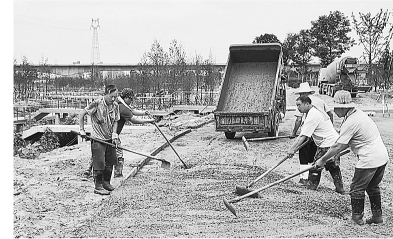
8月7日，工人们对运河公园地面进行硬化施工。运河公园绿化工程总占地面积约595.8亩，工程以水为核心的生态格局，修复商丘大运河生态系统，打造自然健康的河畔休闲体系。 本报记者 崔坤 摄
