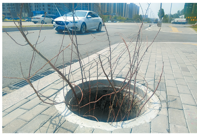
7月1日,归德路与方城路交叉口西北角人行道一侧的窞井盖缺失,给行人通行带来潜在危险。 本报记者 邢栋 摄
