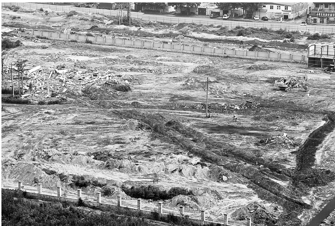
310国道与凯旋路交叉口西北角商丘市妇幼保健院施工工地，防尘网覆盖较少。
