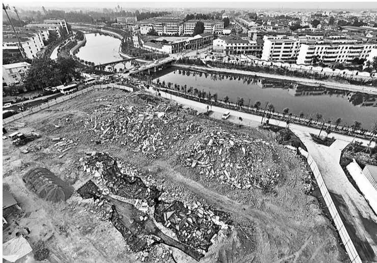
归德路与红旗路交叉口附近的建筑垃圾覆盖不彻底。
