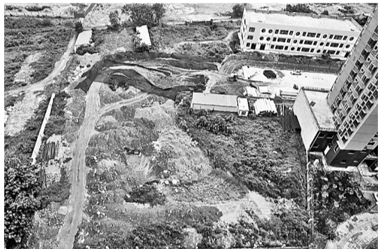
康城花园内施工现场，防尘网覆盖不完全。
