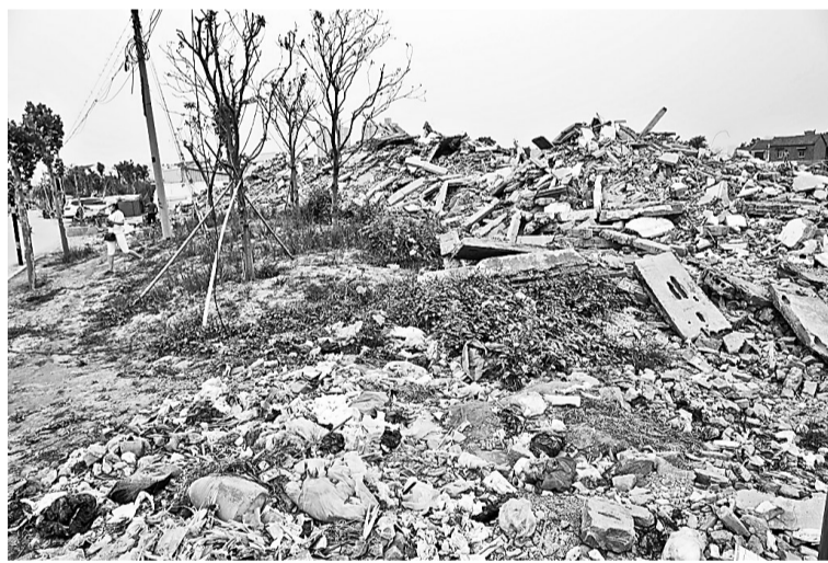
归德北路与红旗路交叉口东北角加油站拆迁工地围挡和防尘网不完整。
