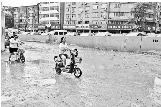
凯旋路与凯四街交叉口，立交桥东侧路面受损，有污水污泥，未见防护措施。
