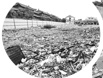
睢阳区古城隍庙拆迁建筑垃圾未覆盖。
