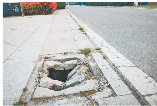
4月9日,包河(南京路至江华路段)河岸西侧步道,窨井盖破损,给行人通行带来危险。 本报融媒体记者 邢栋 摄
