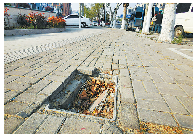
4月18日,睢阳大道与北海路交叉口西北角,人行道上井盖破损,给行人通行带来不便,同时存在安全隐患。
