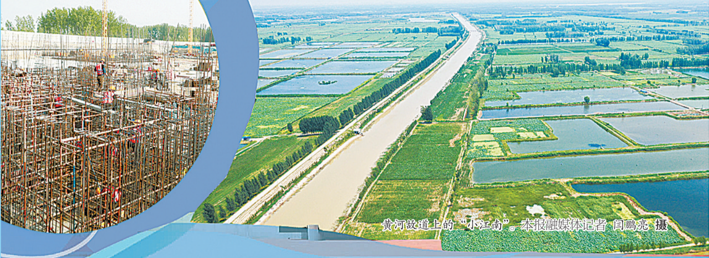
民权县高新区正在建设中的新材料项目工地。本报融媒体记者 闫鸣亮 摄
