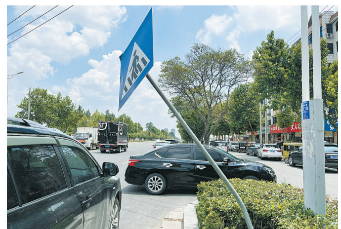
7月10日,在建设路与平原路交叉口东约50米路南,一处交通指示牌受损倾斜,存在安全隐患。 本报融媒体记者 崔坤 摄
