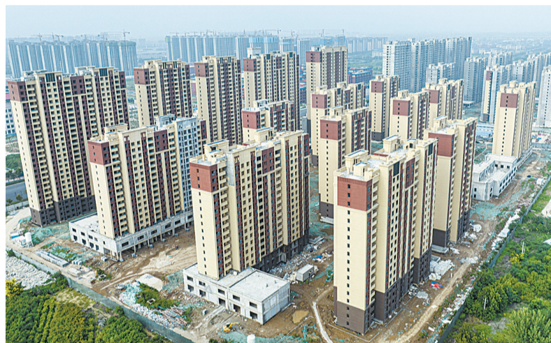
7月16日,建设中的京九新城一期棚户区改造项目(无人机照片)。该项目位于市第一高级中学新校区南侧,总建筑面积60多万平方米,可安置群众4122户。目前项目主体施工已完工,正在进行装饰装修施工及配套建设。
