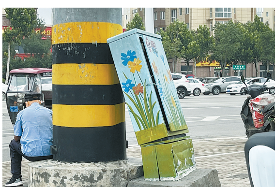
8月6日记者看到,在平原路与文化路交叉口西南角,一处弱电箱受损倾斜。本报融媒体记者 崔坤 摄
