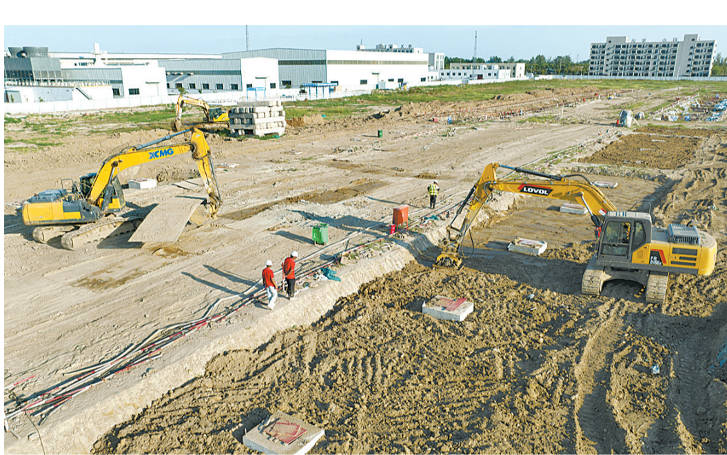
8月15日,大型机械在神火新能源动力电池材料项目施工现场忙碌着。该项目是神火集团规划的重点项目和转型升级示范项目,主要生产电池箔及电池软包装箔,年产量可达6万吨。项目致力于打造中原最大、最有国际影响力的新能源汽车动力电池材料生产基地。本报融媒体记者 崔坤 摄
