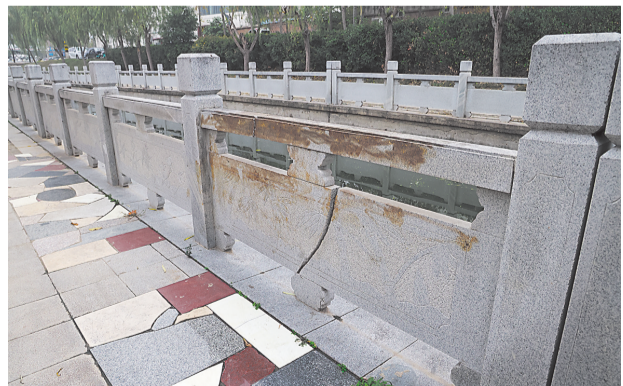
近日记者在蔡河(北海路至香君路段)河岸看到,河岸护栏破损,存在安全隐患。 本报融媒记者 邢栋 摄
