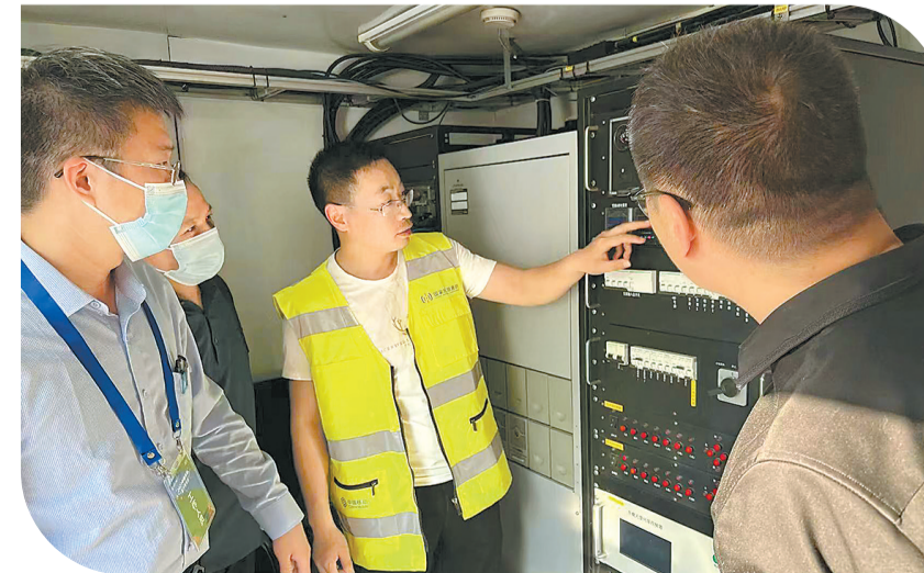
应急通信保障人员在保障车内进行保障知识讲解。
