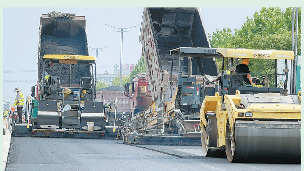
8月22日，G105线（连霍高速匝道—睢阳区坞墙镇段）结构性修复工程施工现场，施工人员正在利用当前高温的有利时机加紧进行油面铺设。工程自开工以来，施工单位克服天气炎热、施工路段过往车辆多等困难，科学合理安排人力物力和作业面，严把质量，稳步推进工程建设。本报融媒体记者 邵群峰 通讯员 杨明杰 摄
