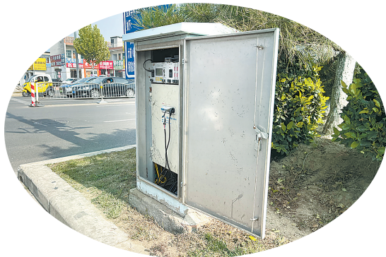
11月6日，在平原路与民主路交叉口东南角，一处弱电箱盖子敞开，电线裸露在外。
